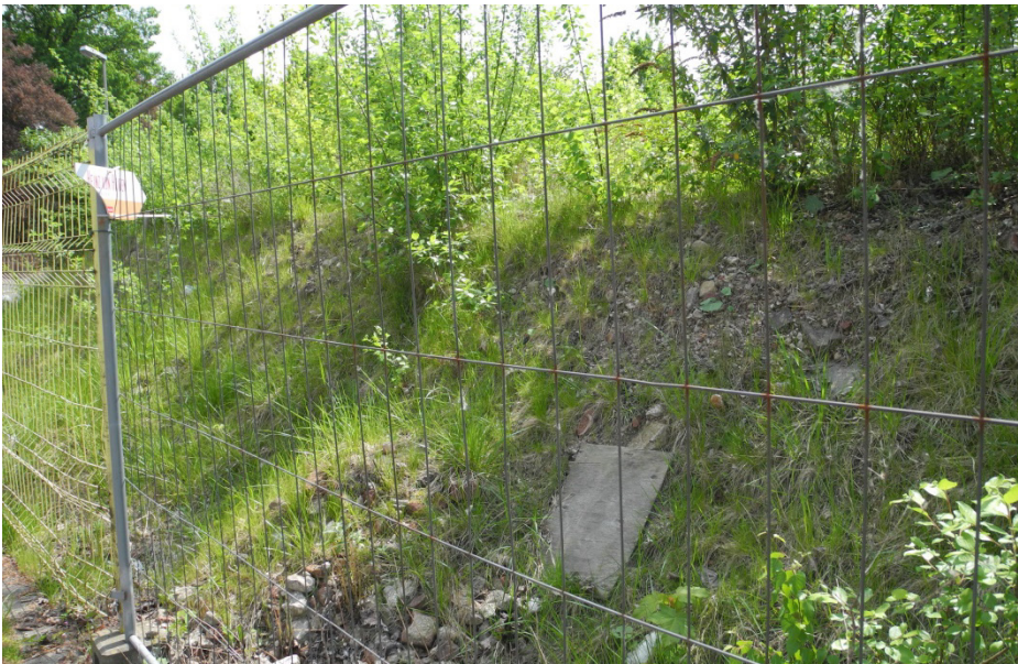
Abb. 5 Böschungsbereiche der Aufschüttung
